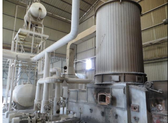
拟拆除的导热油炉
